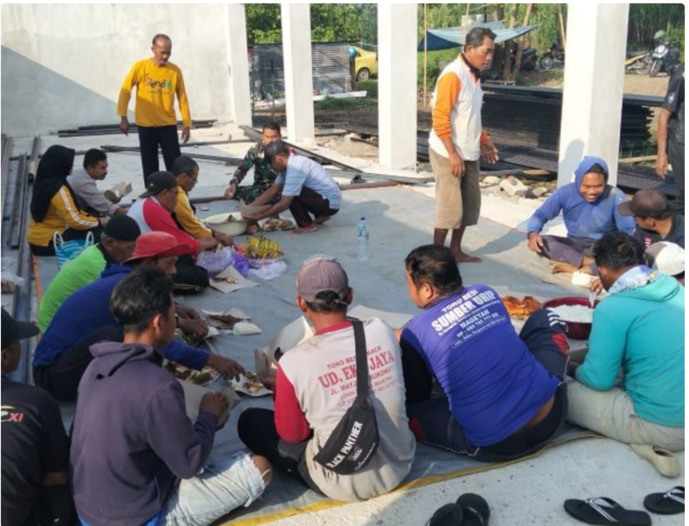
Babinsa Koramil 0804/13 Bendo Hadiri Tasyakuran Pasang Kuda-Kuda Bangunan KDKMP di Wilayah Binaan
